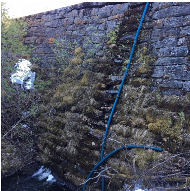
Demninga oppstrøms og nedstrøms den 12. juni 2020. Flomvannet renner i utsprengt overløp. Det er også lekkasjer i bunnen.
